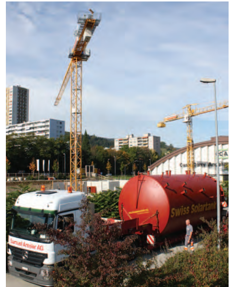
Pufferspeicher Industrie- und Dienstleistungsgebäude
